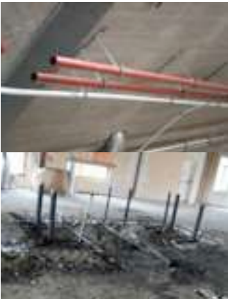
Pijpenwerk onder het plafond en in de vloer van de oude zaal
