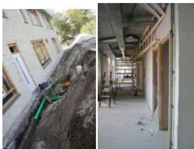
Links: Hemelwaterafvoer aansluiten op de 'plastic dozen' die nu ingegraven zijn. Rechts: Plafondafwerking in de gang begint vorm te krijgen. Mooi om de rechte lijn van het houtwerk te zien tegen de inspringende wanden van de lokalen
