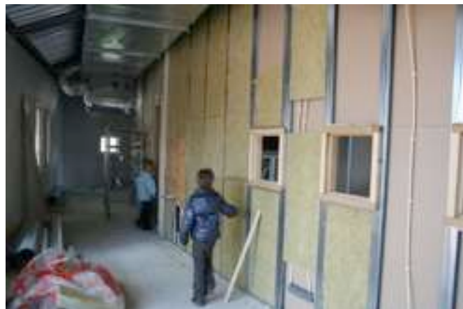
Yoram en Thijmen inspecteren de isolatie voordat de tweede gipslaag er op gaat.
