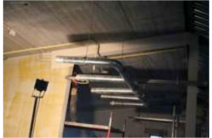
Hier zijn een aantal werklui bezig om het ijzer te omkleden met gips ivm brandveiligheid.
