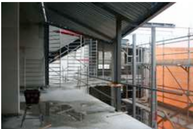
Zicht naar de 'brug' De steigers zijn met netten omspannen om regen en 'troep' zoveel mogelijk tegen te houden.
