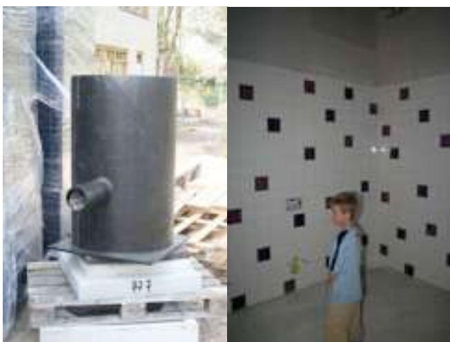
Links: De put voor de hemelwaterafvoer Rechts: Het eerste metselwerk klaar in de wc's
