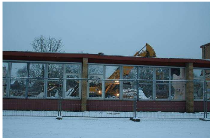
17/12 's morgens 08:45 in de versgevalen sneeuw. De pui staat nog, maar de rest is weg (winkeltje, directiekamer, lerarenkamer, remedial teaching, gang, grootste deel van de lokalen.
